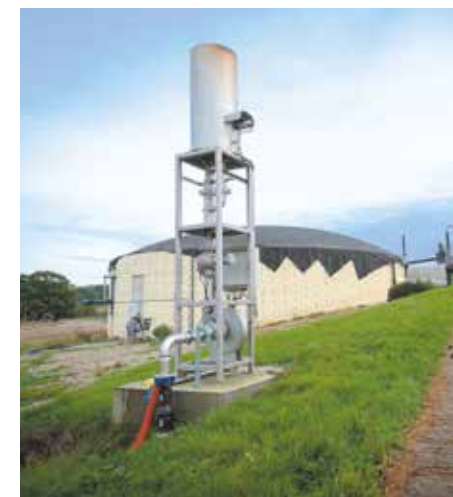
La torchère est mise en fonctionnement pour des raisons environnementales et de sécurité lorsqu'il faut détruire le biogaz.
